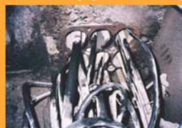
改修前ハンドホール内ケーブル状況
