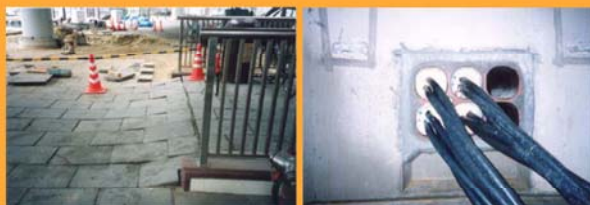
六甲アイランド震災後現場写真
